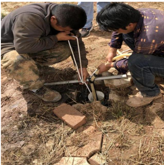
HS5 下放抽水泵
